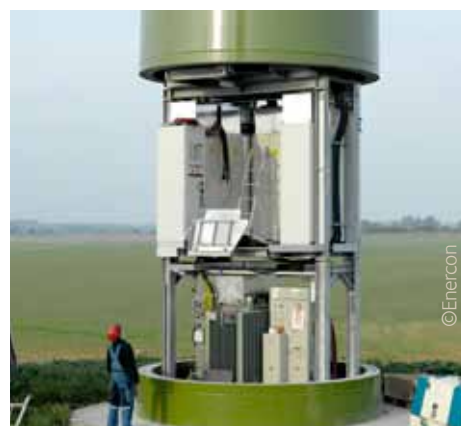
Abbildung 8: Transformator und Schaltgeräte
