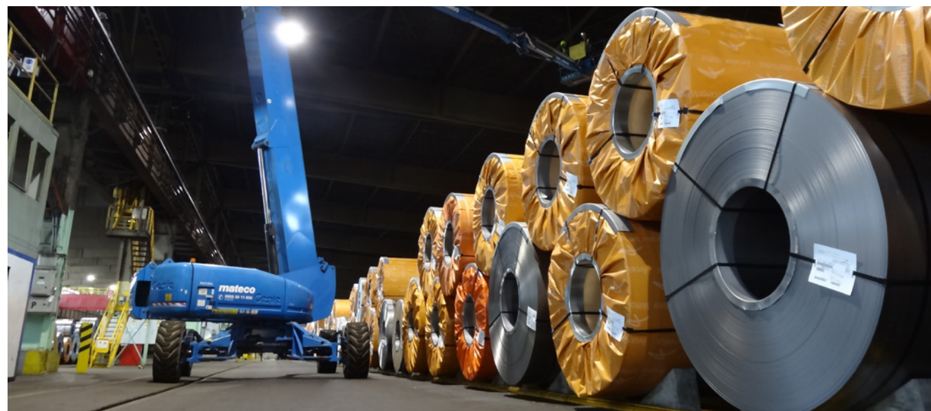
Für die optimale Ausleuchtung der Halle führt Conled eine Lichtberechnung durch. Auf dieser Grundlage werden die alten Hallenlampen im Kaltwalzwerk demontiert und durch LED-Beleuchtung ersetzt.
